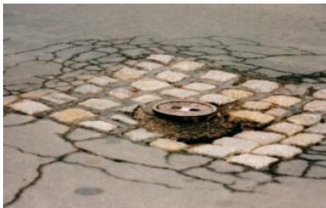
Foto 3: se il chiusino non viene installato nella maniera corretta si rende necessario intervenire intorno allo stesso danneggiando l'asfalto.
