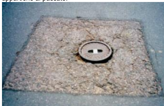
Foto 2: il manto stradale è danneggiato intorno al chiusino a causa del livellamento dell'asfalto dopo l'installazione.
